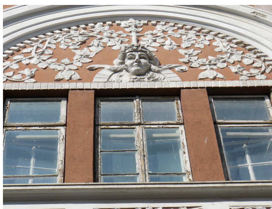
Фиг. 5 Детайл от доходното здание на Жозефина Фройнд, 1912 г., инж. Йосиф х. Стоянов
